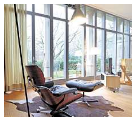
Die Fensterfront war anfangs instabil, erhielt nachträgliche Stützen
